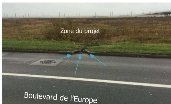
Figure 37 : Système d'écoulement des eaux pluviales du Boulevard de l'Europe
